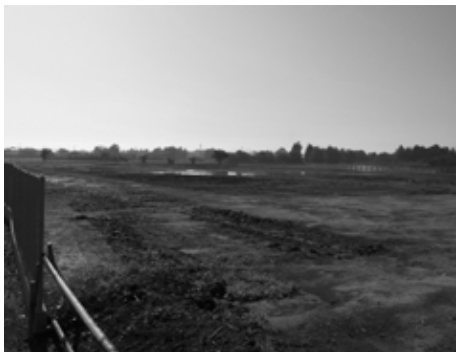
整地され間もなく工事が進められる給食センターの建設予定地。来年の第2学期からの稼働を目指す（野田地内）
