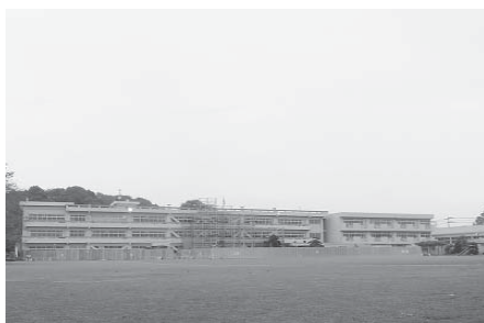
限られた財源の中で耐震化を促進するには、将来的な児童生徒数の推移を勘案し、小中学校等の適正規模、配置のあり方を示す必要がある(平成22・23年度にかけて耐震補強工事を行う羽鳥小学校)
