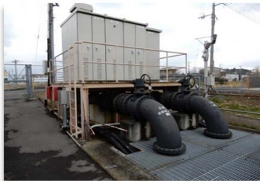
更新される排水施設ポンプ
