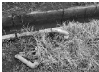
蛇口を盗難された給水管
