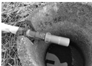
対策で蛇口を取り外した給水管
