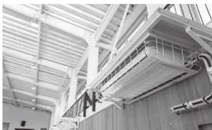
▲長寿命化工事で設置した空調設備（美野里中体育館）
